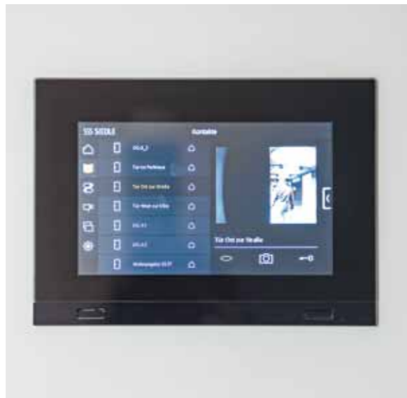
Zukunftsweisende Technik: Mit dem smarten Display können per Fingerdruck unterschiedliche Funktionen gesteuert werden.
